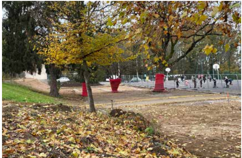
Des travaux de désimperméabilisation de la cour de l'école Condorcet ont débuté en décembre.
